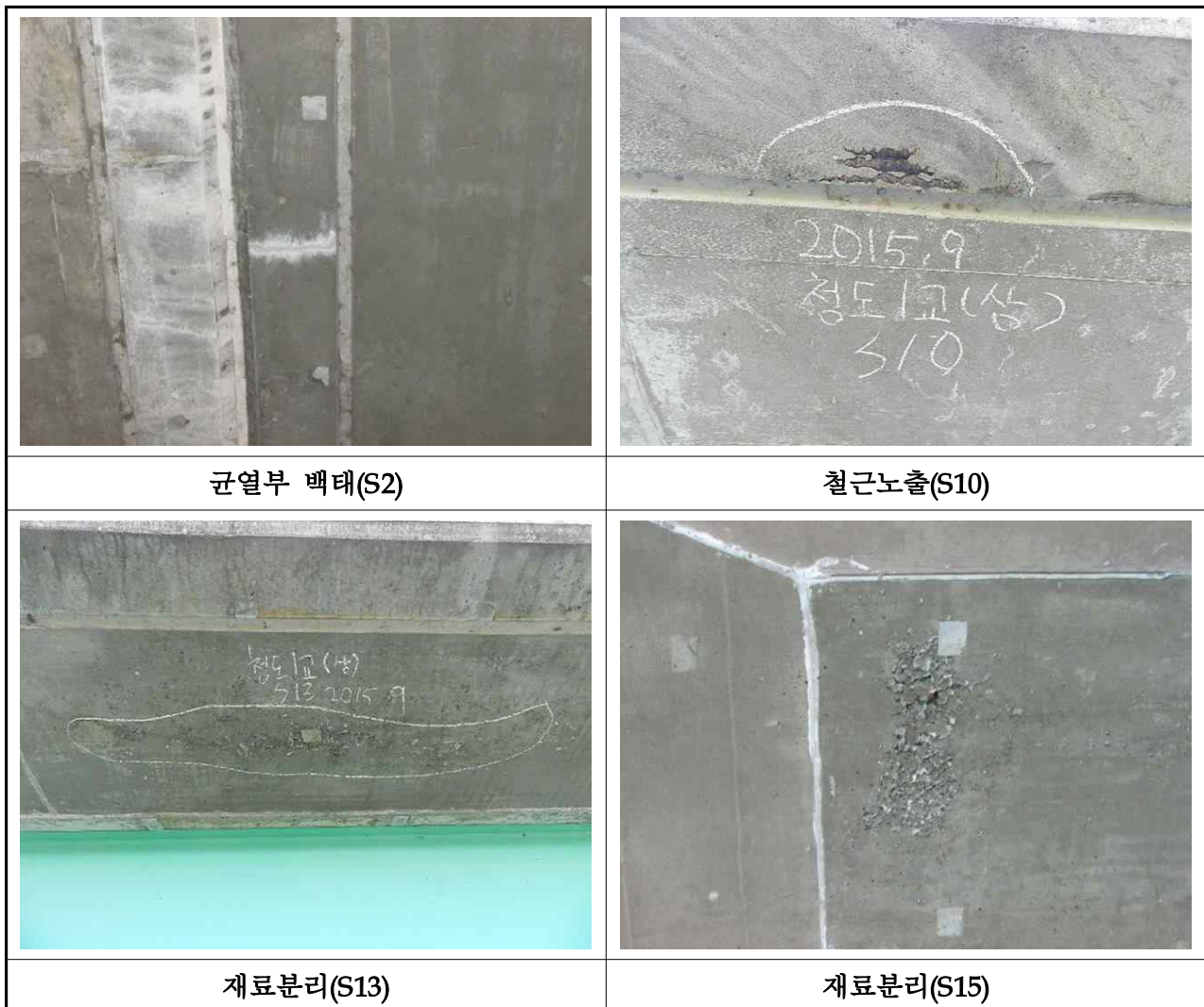
【사진 3.2.2】 바닥판 손상현황(대구)
