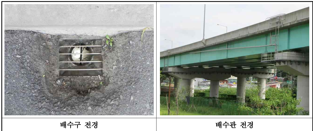
【사진 3.3.19】 배수구 및 배수관 전경(부산)
