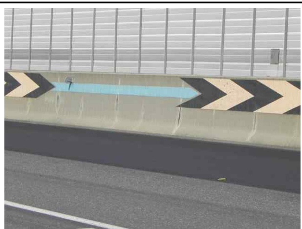
균열 및 백태(S8)
