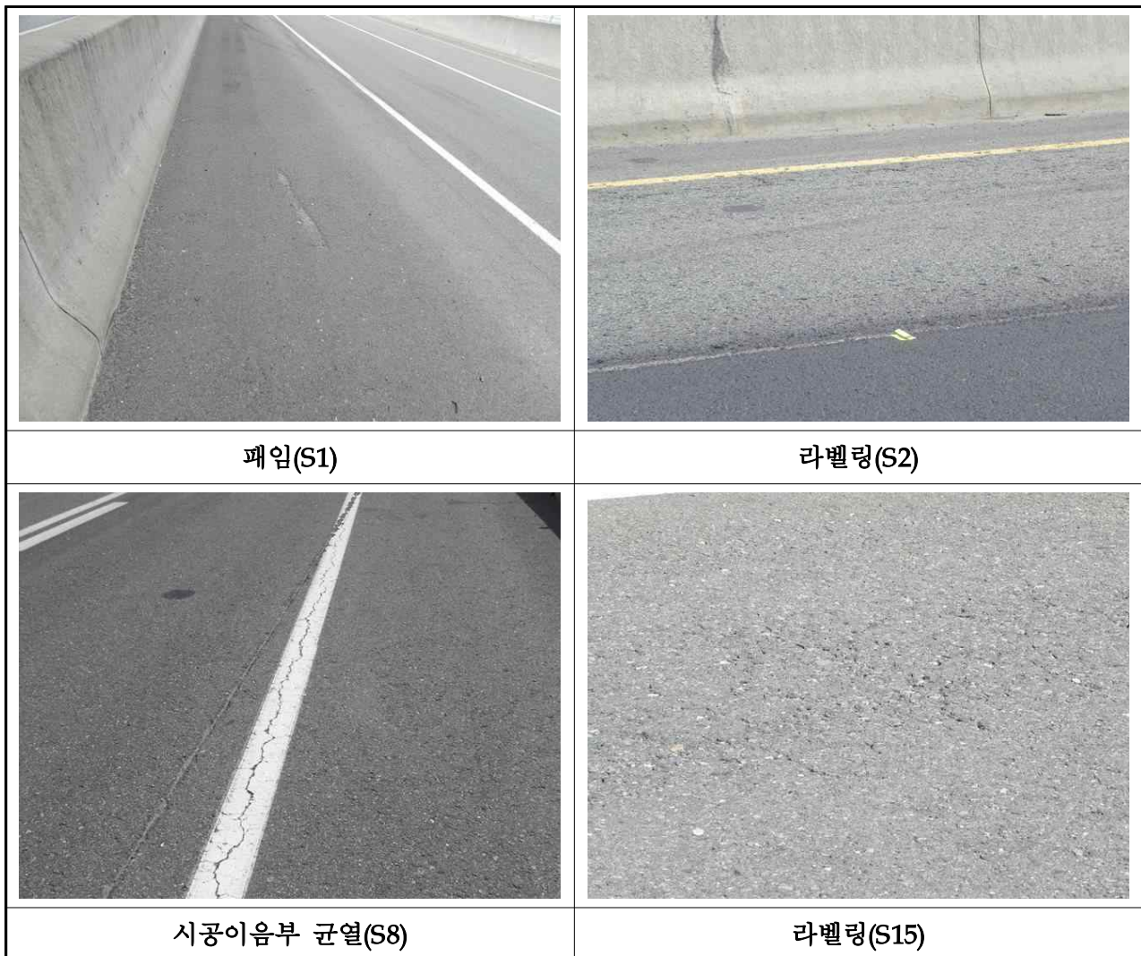
【사진 3.3.18】 교면포장 손상현황(부산)
