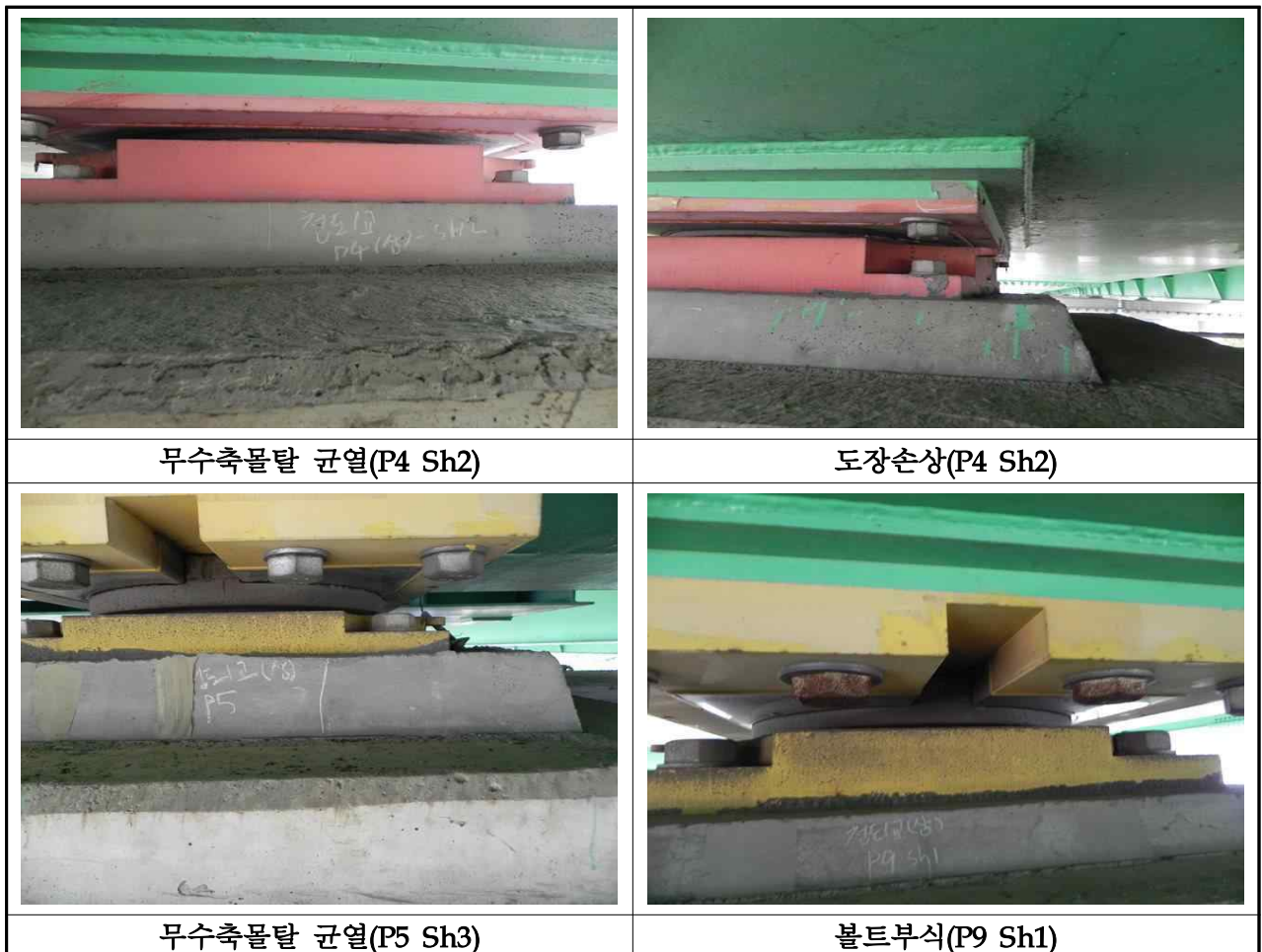
【사진 3.2.10】 교량받침 손상현황(대구)
