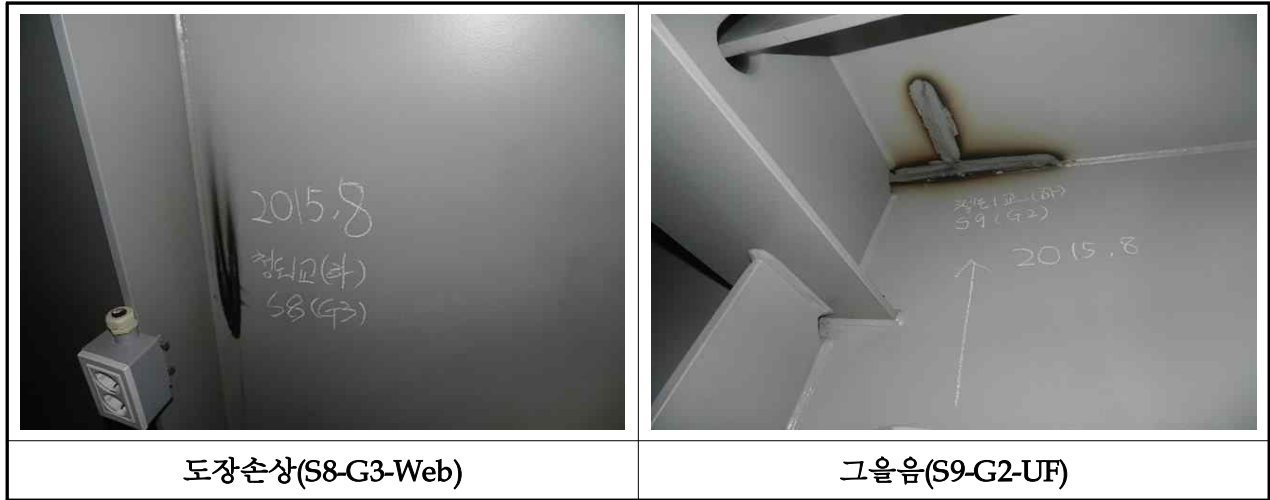
【사진 3.3.4】 강박스 거더 내부 손상현황(부산)
