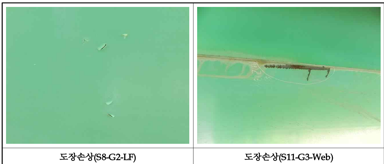
【사진 3.3.5】 강박스 거더 외부 손상현황(부산)
