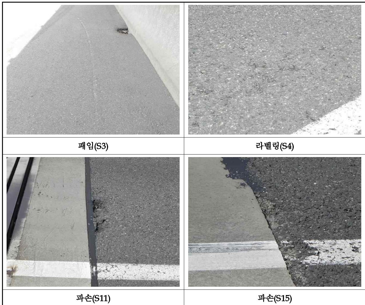
【사진 3.2.16】 교면포장 손상현황(대구)
