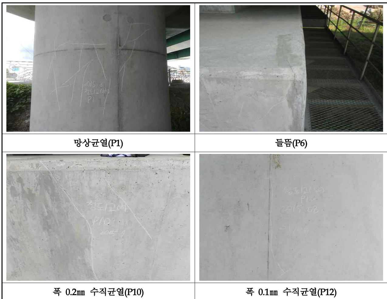
【사진 3.3.10】 교각 손상현황(부산)
