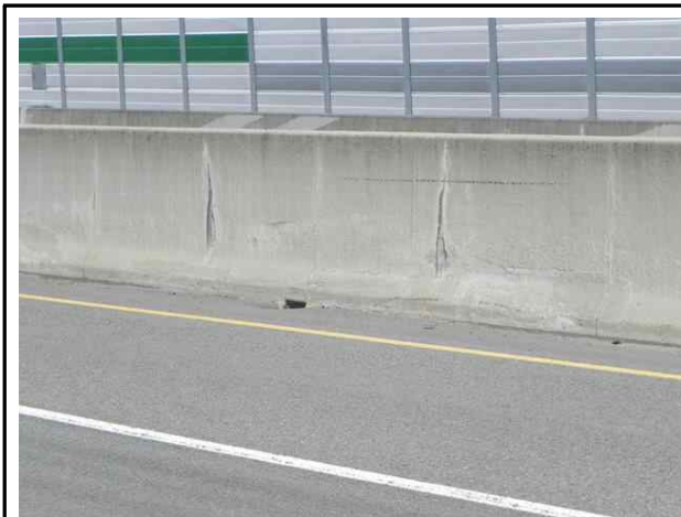
균열 및 백태(S1)
